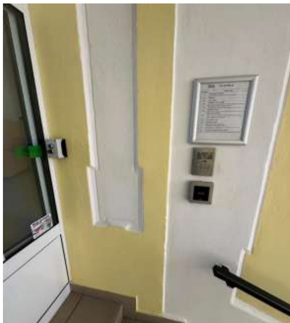
Zvonky a čtečka u hlavního vstupu
